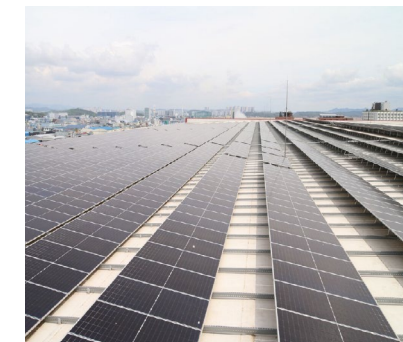
시화MTV센터 태양광 발전시설
